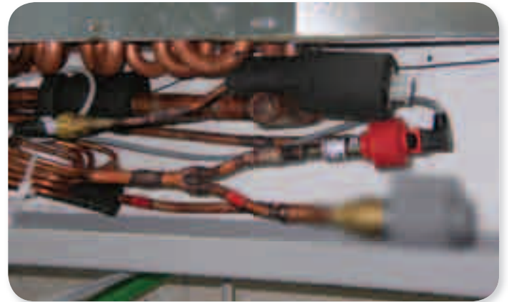
Instalação em paralelo das válvulas E2V e PWM
