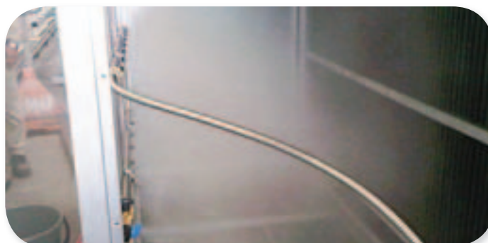
raffreddamento evaporativo con acqua atomizzata
