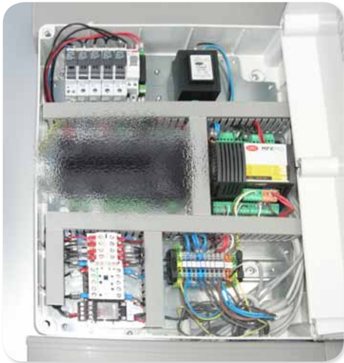
電気パネルに構築されたパルス幅変調PWMとE2Vとの間の手動切換えまたはPlantVisorPROによる切換え
