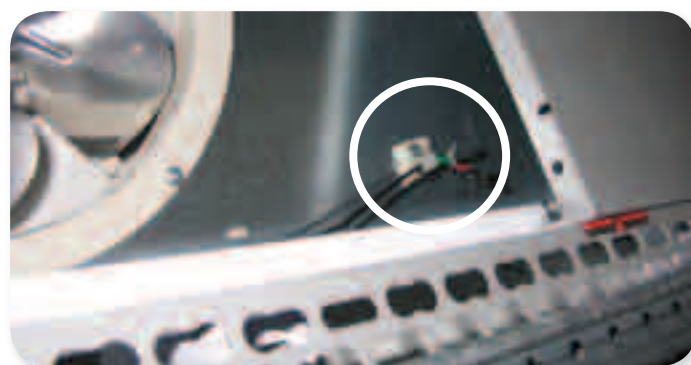
les sondes ont été doublées pour mesurer la même valeur de température/pression
