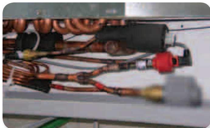
installation en parallèle des détendeurs E2V et PWM
