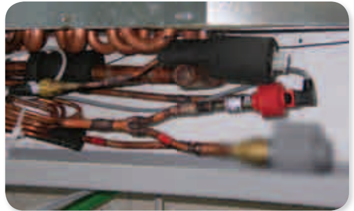
Instalación en paralelo de las válvulas E2V y PWM
