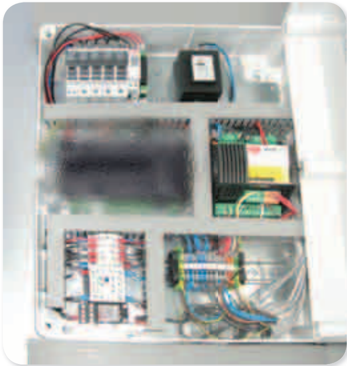
el cuadro eléctrico ha sido preparado para permitir el cambio de tecnología entre PWM y E 2 V manualmente o vía supervisor PlantVisorPRO
