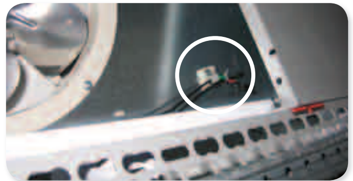
Todas las sondas duplicadas han sido instaladas para medir el mismo valor de temperatura/presión
