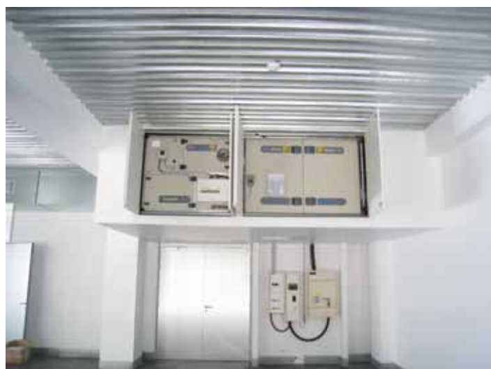
Пример компактного монтажа агрегата GOLD RX с холодильной машиной
