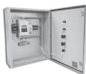
Щит (шкаф) управления типа ЩУВ, стр. 330
